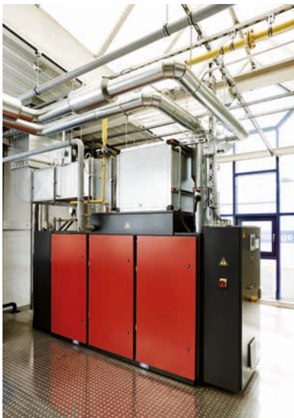
Druckluft-Wärme-Kraftwerk in der Energiezentrale der Bosch Thermotechnik GmbH in Lollar. (Foto: Bosch)
