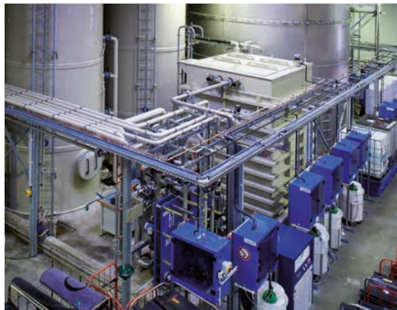
Anlage zum Abwasserrecycling in einer Großwäscherei: Bis zu 70 Prozent des benutzten Wassers werden aufbereitet und gelangen zurück in die Wäscherei. (Foto: EnviroChemie)
