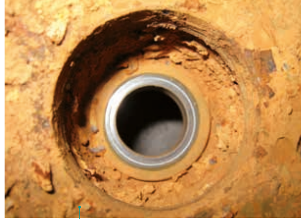
Korrodierte Pumpenteile: Chlorid im Schwimmbadwasser greift Gusseisen an. (Foto: Herborner Pumpentechnik GmbH & Co KG)
