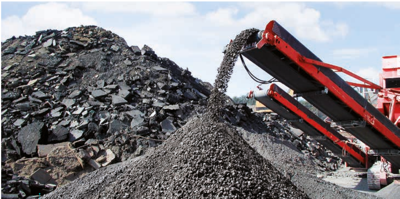
Bauschutt: Nach Aufbereitung kann das Material erneut verwendet werden, etwa im Straßenbau. (Foto: Baureka)
