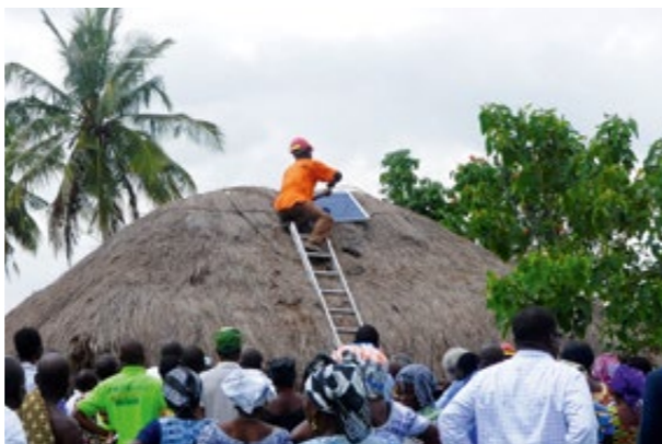
Erfolgreiches Crowdfunding: Mit 224.200 Euro von insgesamt 390 Investoren wurden in Nigeria Solar-Home-Systeme in netzfernen Haushalten installiert.
