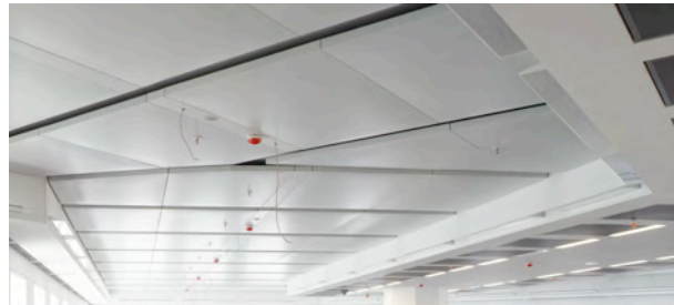
Heiz-/Kühldecken mit Graphit-Elementen im verkleideten Zustand
